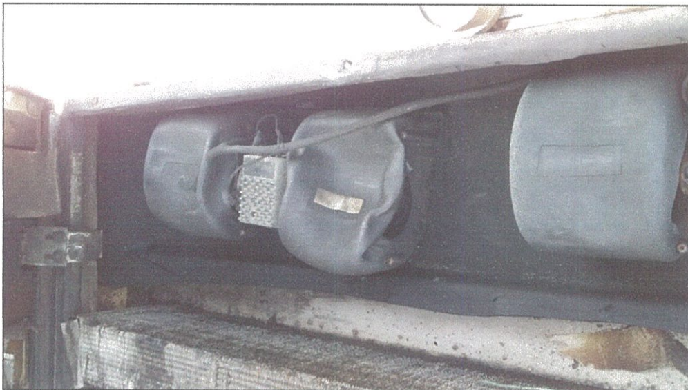
Gambar 6. Blower yang rusak terlepas dari dudukannya
