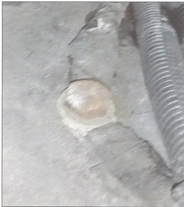
Gambar 15. Karat pada Bonding Grounding
