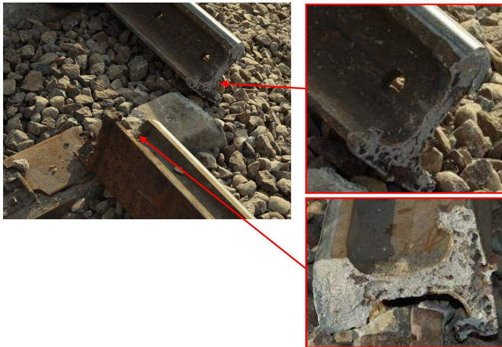
Gambar 15. Rel patah akibat PLH
