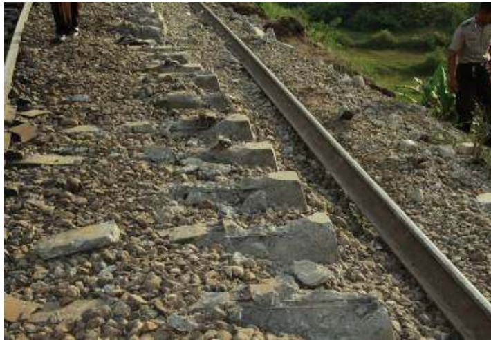
Gambar 3. Bantalan beton, rel dan penambat KA Clip yang rusak akibat PLH
