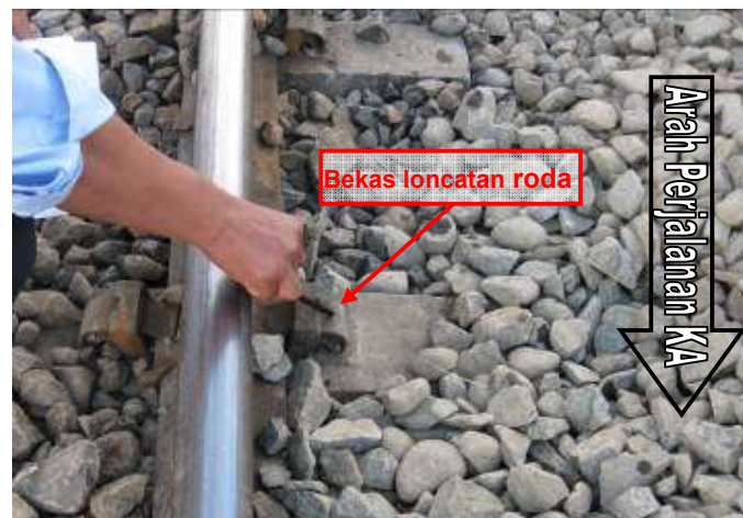
Gambar 10. Bekas loncatan roda KA 158 Logawa pada penambat sebelah kiri jalan rel
