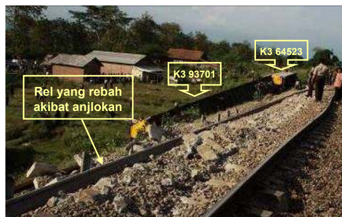
Gambar 13. Rel rebah akibat PLH
