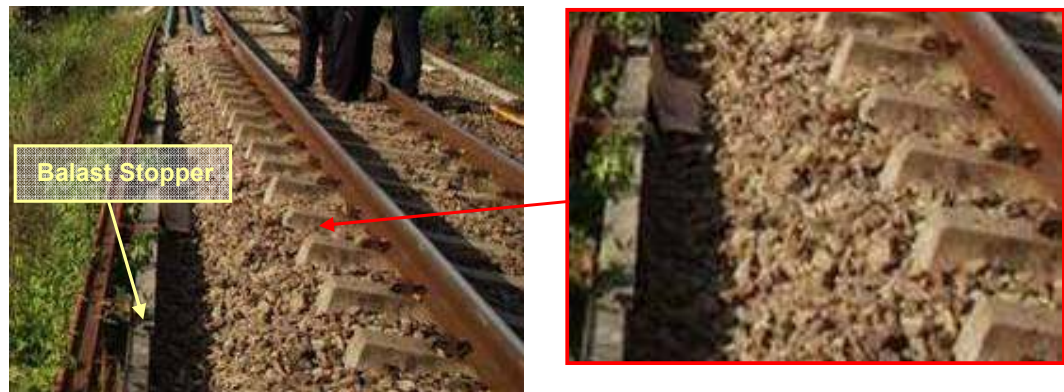
Gambar 14. Kondisi jalan rel yang kurus/ tipis
