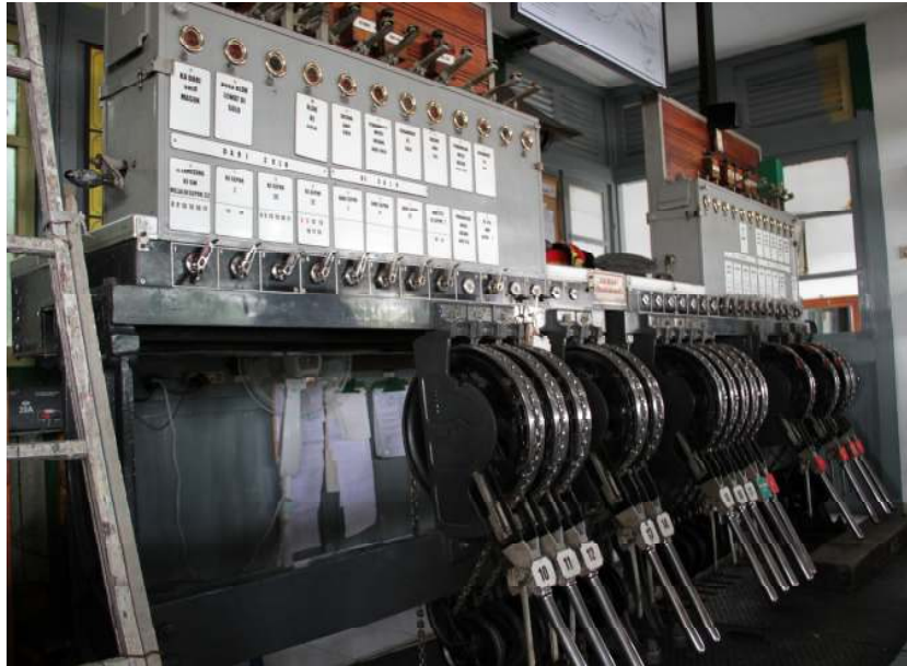
Gambar 6. Pesawat blok di ruang PPKA St. Purwosari
