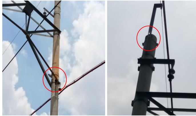
Gambar 8. Pole band rusak terbakar
