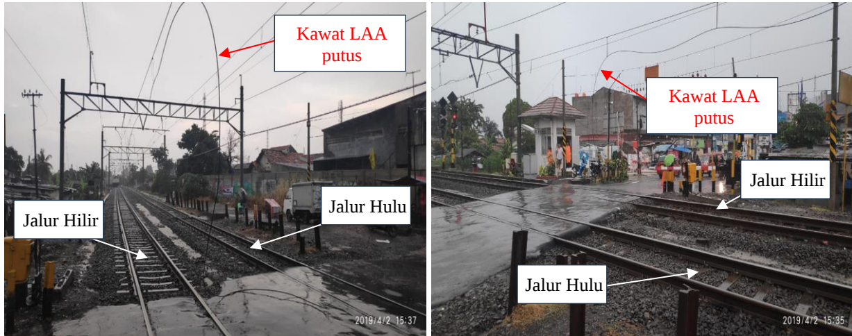
Gambar 1. Kawat LAA yang putus dan menjuntai di Km 27+2/3 jalur hilir antara Bekasi Timur-Kranji
