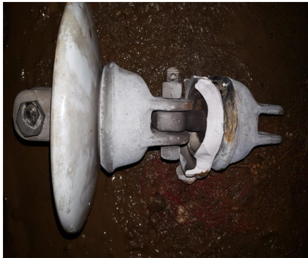
Gambar 6. Isolator EPC yang rusak pecah
