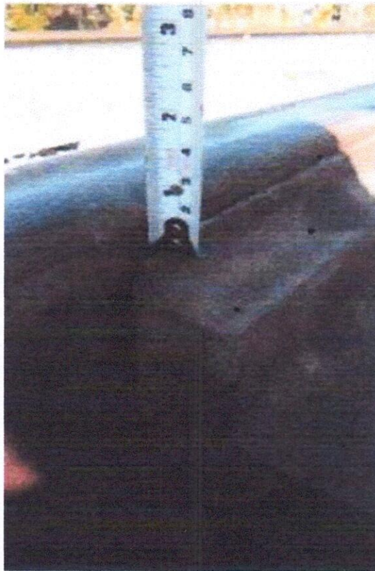
Gambar 4. Perbedaan tinggi antara lidah rapat dengan rel lantak pada lidah kiri Wesel 11A
