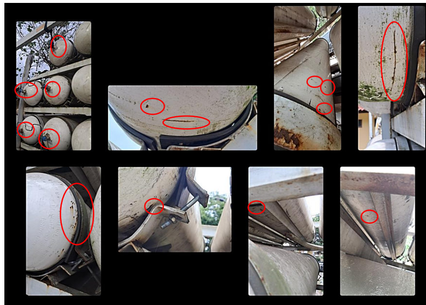
Gambar 17. Korosi awal ( initial corrosion ) pada bagian luar tabung yang mengalami kerusakan pada lapisan cat (lingkaran merah)
