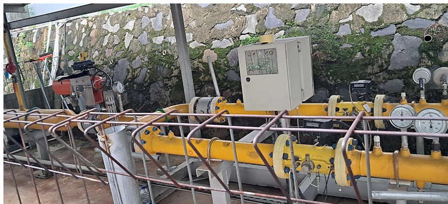
Gambar 23. Gas alam masuk melalui jaringan pipa gas (Pipa Transmisi Jawa Barat)
